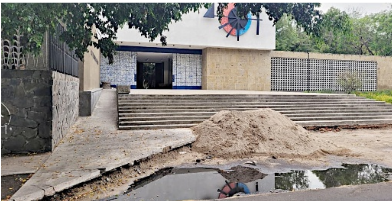
La banquetta que da a la Casa de la Cultura fue destruida para dar paso a un apeadero; se volverá a construir.
